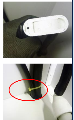
加湿器内部、右側下部
