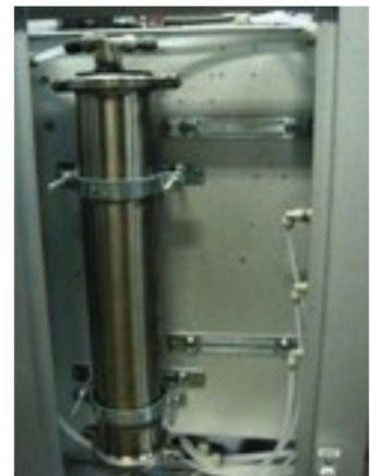
ROモジュール
