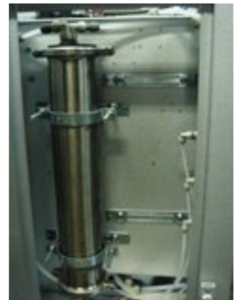
ROモジュール
